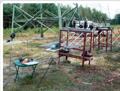
Fot. 2. Stanowisko do badań skutków oddziaływań w czterotorowej linii 110–15 kV
