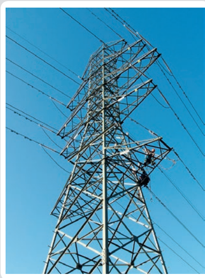
Fot. 1. Słup rozpatrywanej linii na odcinku trójtorowym (dwa tory 110 kV, jeden tor 15 kV)
