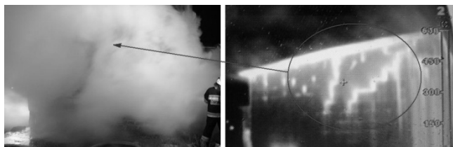
Rys. 2. Obraz termiczny ściany kotłowni, na którym widać pęknięcia i fotografia tego miejsca
