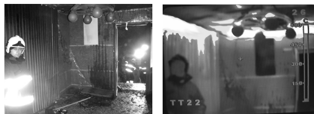
Rys. 1. Fotografia i obraz termiczny ścian i sufitu gaszonego pomieszczenia.
