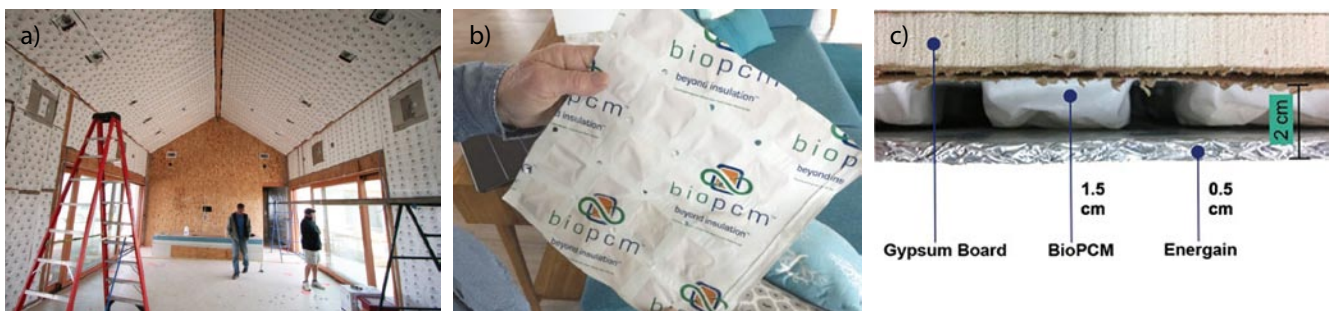
Rys. 7. Obiekt Casa Aguila w czasie realizacji: a) salon z widoczną okładziną ścian i sufitu membraną BioPCM, b, c) wykończenie wewnętrzne ścian i sufitu – płyta g-k + membrana BioPCM + membrana DuPont Energain® PCM o grubości 5 mm [8]
