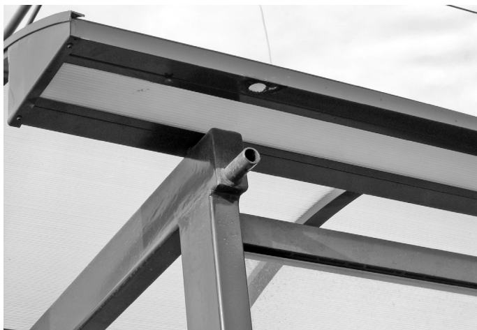
Fot. 10. Widok rynny dachowej i rzygacza odprowadzający wodę opadową z dachu wiaty
