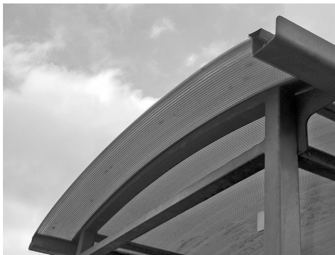
Fot. 7. Brak zamknięcia brzegu swobodnego płyty poliwęglanowej dachu
