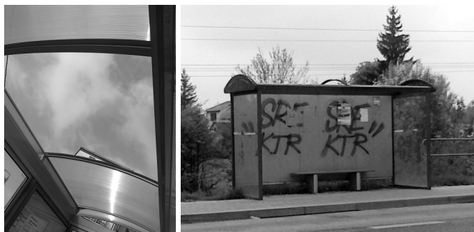
Fot. 5. Brak jednej z płyt dachowych z poliwęglanu
