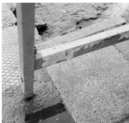
Fot. 9. Uszkodzenie powłoki malarskiej pokrywającej konstrukcję wiaty przystankowej
