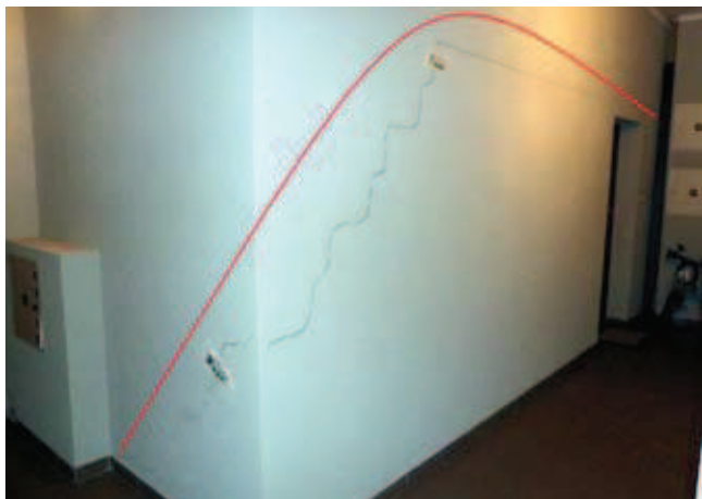
Fot. 2. Uszkodzona wskutek ugięć stropu ściana działowa z bloczków silikatowych o grubości 24 cm oraz kształt powstałego w ścianie łuku, utrzymującego w równowadze część ściany nad pęknięciem (fot. A. Klimek)
