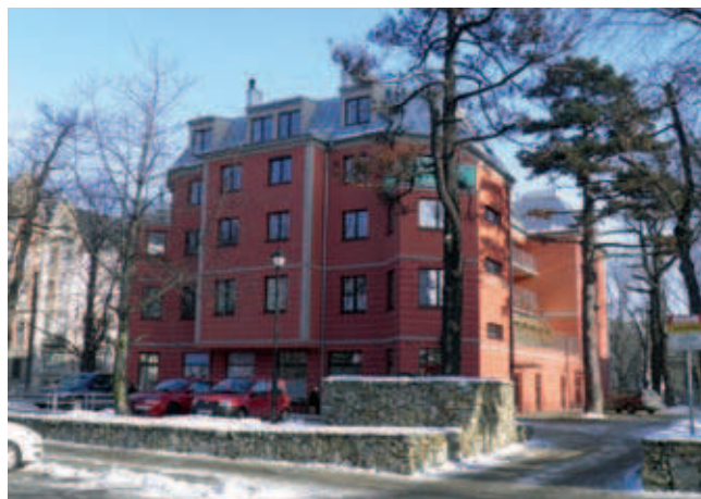
Fot. 1. Budynek, w którym wystąpiły nadmierne ugięcia stropów oraz wywołane nimi pęknięcia ścian działowych (fot. Z. Matkowski)
