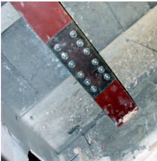
Fot. 4. Jedna z 2 stalowych belek podpierających ugięty strop Teriva nad parterem (fot. A. Klimek)
