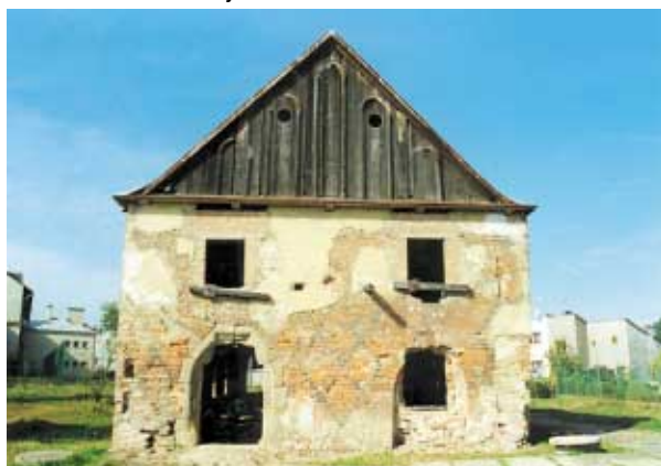
Rys. 5. Szpital św. Jadwigi. Elewacja wsch. Stan w 1999 r. Fot. Archiwum WO SOZ w Krakowie
