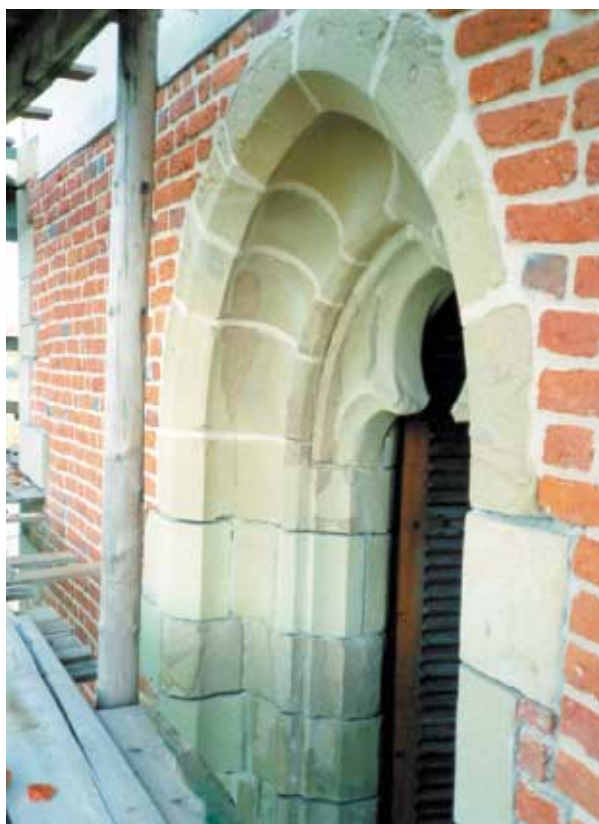
Rys. 7. Dzwonnica przy kościele farnym. Szczyt okna zach. Stan po wykonaniu flekowania i uzupełnieniu ubytków. Fot. Archiwum WO SOZ w Krakowie
