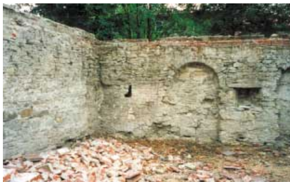
Rys. 4. Mury obronne klasztoru Franciszkanów-Reformatów. Fragment odsłonięty podczas prac porządkowych w 2001 r. Fot. J. Lejmel
