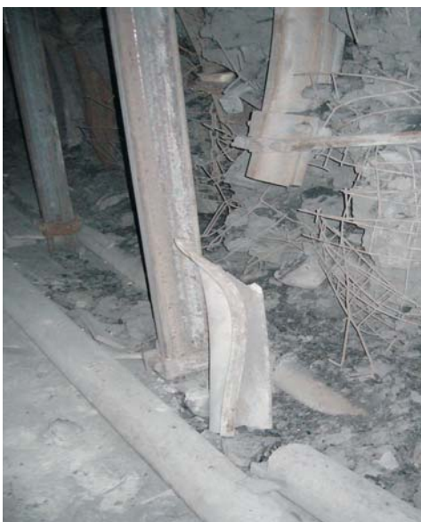
Rys. 26. Widok ściętego łuku ociosowego w chodniku 5a w pokładzie 408/1
