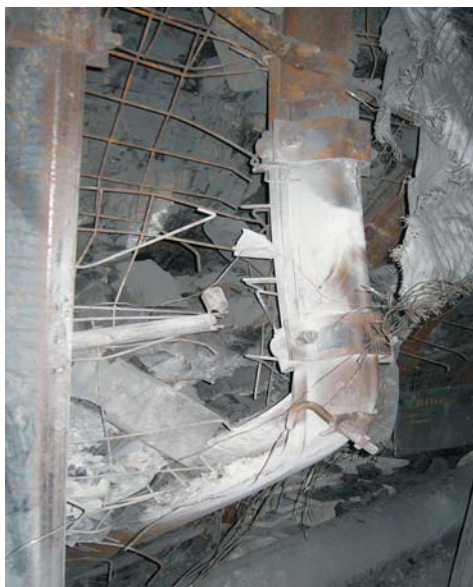
Rys. 25. Widok zdeformowanego łuku ociosowego w chodniku 5a w pokładzie 408/1
