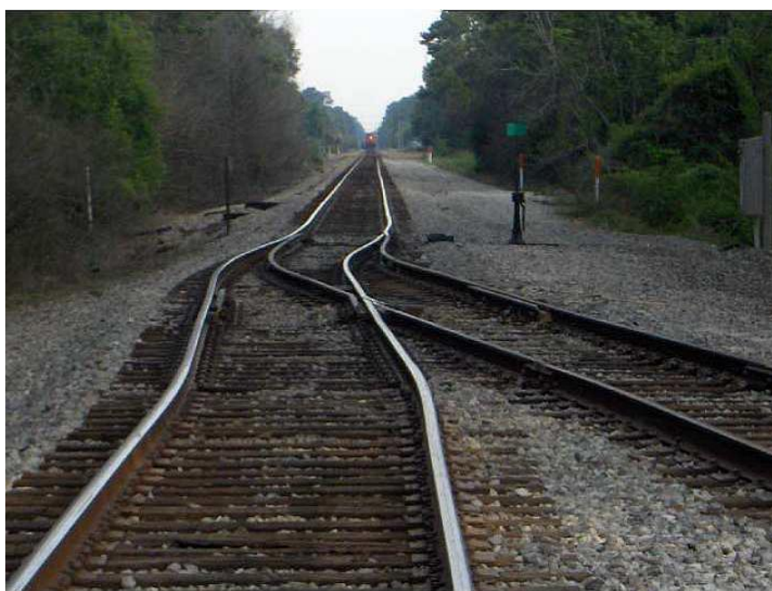
Rys. 4. Wyboczenie toru na rozjeździe. [Archiwum Instytutu Kolejnictwa]
