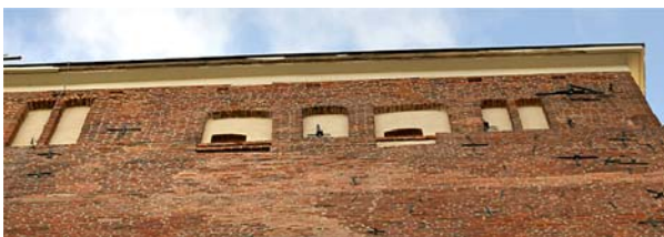
Ryc. 4. Ubytki gzymsu wieży południowej po usunięciu odpajających się fragmentów Fig. 4. Cavities in the cornices of the southern tower after removal of delaminating fragments
