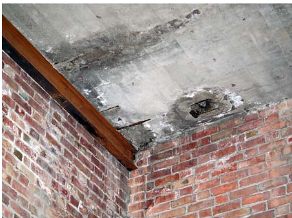
Ryc. 8. Miejscowe zawilgocenia współczesnego, pochodzącego z lat 60. XX wieku, stropu żelbetowego najwyższej kondygnacji, w środkowej partii bloku wieżowego
