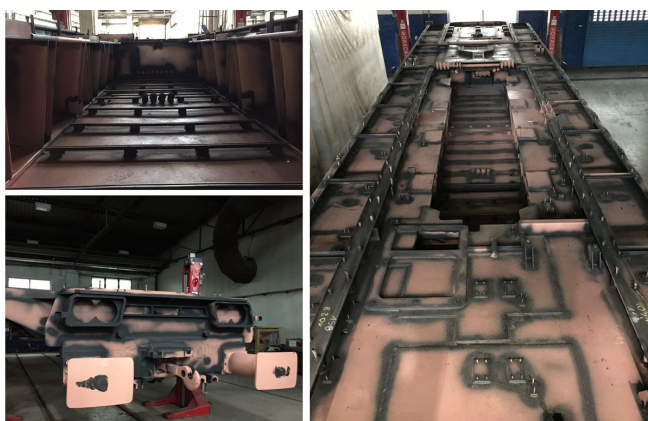
Rys. 5. Widok ostoi lokomotywy po modyfikacji uwzględniającej naprawę i przystosowanie pod zabudowę nowych urządzeń i zespołów
