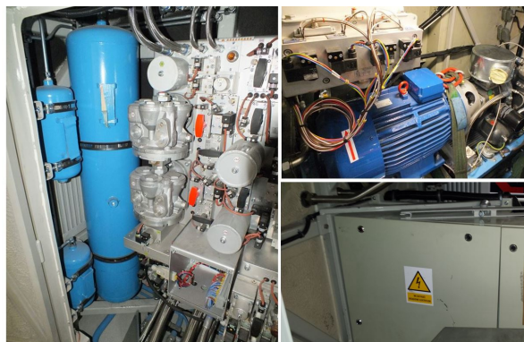
Rys. 12. Zabudowa głównych zespołów układu pneumatycznego w zmodernizowanej lokomotywie 19D
