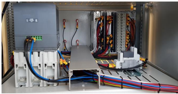
Rys. 4. Urządzenia tworzące stanowisko badawcze [3]
