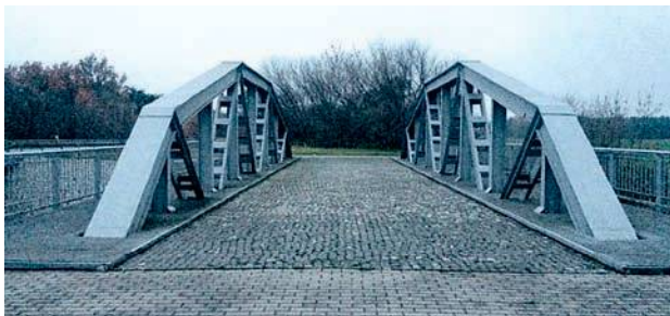
Rys. 1. Stan obecny historycznego mostu kratowego w Maurzycach. Fig. 1. Current condition of the historic truss bridge at Maurzyce.
