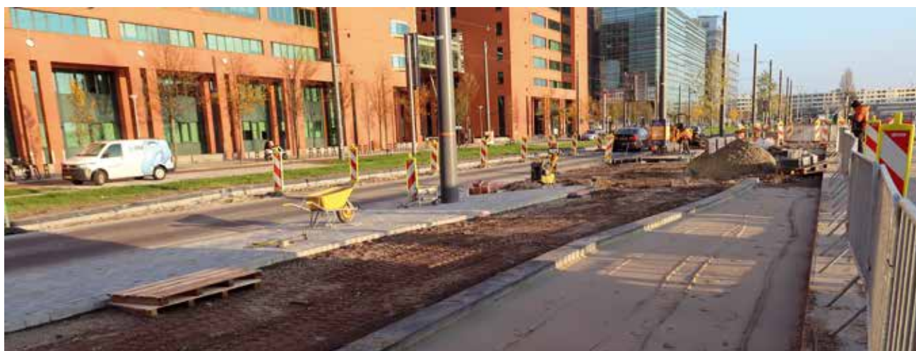
Rys. 3. Prace drogowe polegające na „zawężeniu” pasa drogowego i budowie dodatkowej ścieżki rowerowej i pasa zieleni. Posthumalaan, Rotterdam; źródło: fot. Szymon Opania
