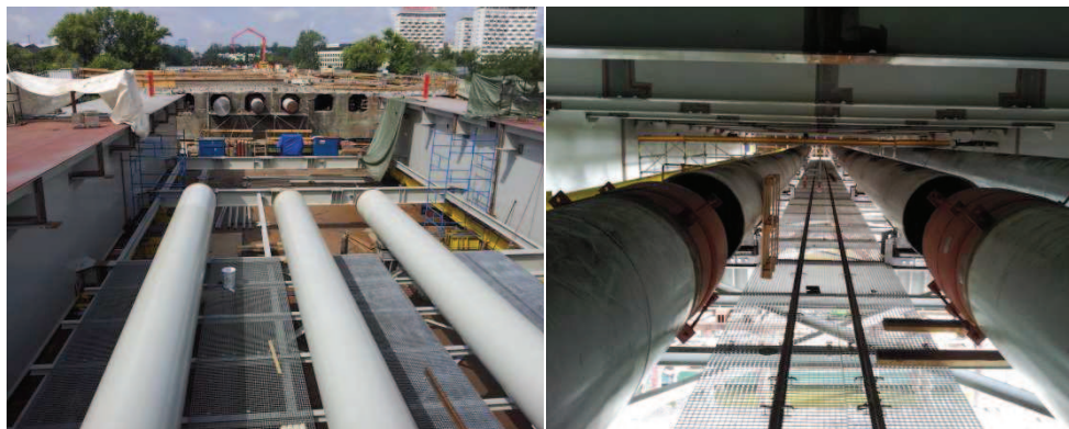
Zdjęcia 9 i 10. Urządzenia obce pod mostem
