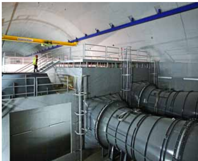
Maszynownia urządzeń wentylacyjnych
