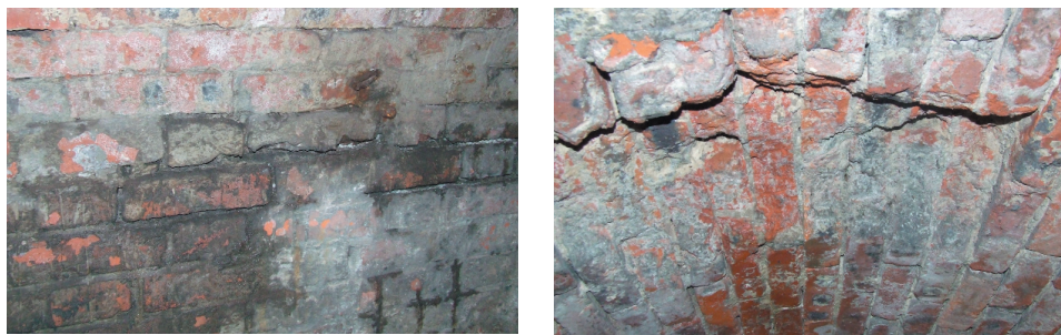
Ryc. 3. Ubytki lica cegły oraz ubytki zaprawy w spoinach spowodowane przemarzaniem obudowy Kopalni Ćwiczebnej „SztYGarka” w Dąbrowie Górniczej
