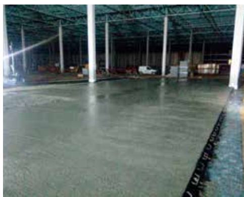
Rys. 14. Posadzki z cementu portlandzkiego wieloskładnikowego CEM II/B-M (S-V) 42,5N: posadzka o pow. 40 000 m 2 (po lewej), posadzka o powierzchni 50 000 m 2 (po prawej)
