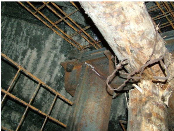
Rys. 42.18 Pękanie połączenia prostki spawem ze stojakiem od działania obciążenia ociosowego.
