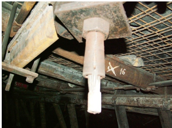
Rys. 42.19 Pękanie tulei kotwi strunowej zabudowanej w podciągu.
