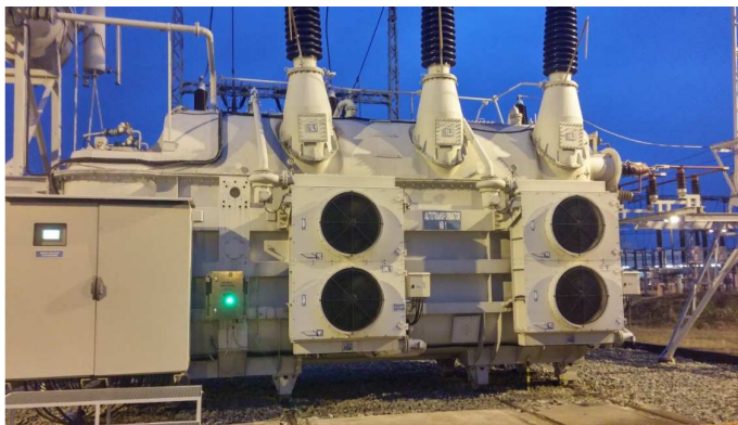
Fot. 1. Autotransformator AT1 z widocznymi zespołami wentylatorów chłodzących
