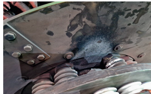
Rys. 7. Widok części głowicy silnika pierścieniowego objętej działaniem łuku elektrycznego, w wyniku czego uszkodzeniu uległy izolatory porcelanowe oraz tarcza złożona z dwóch półpierścieni [opr. wł.]
