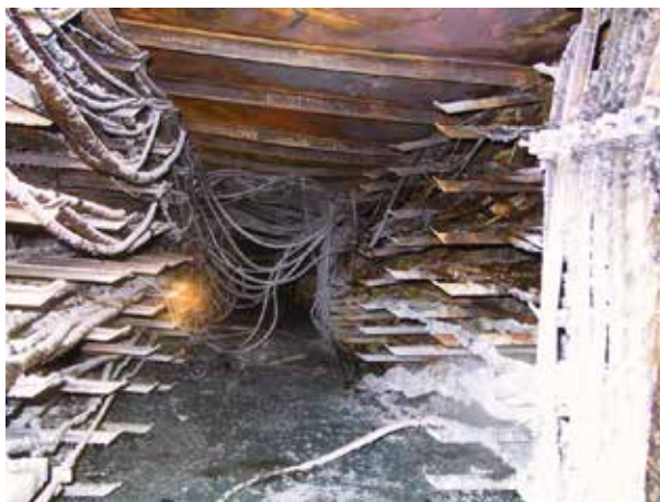
Rycina 10. Skutki pożaru wiązek kabli elektrycznych Figure 10. The impact of fire on electric cable bundles
