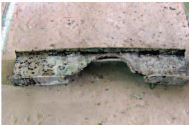
Fot. 9. Widok belki wyciętej ze stropu i położonej na boku. Pas dolny dwuteownika został rozerwany przez pocisk artyleryjski, który zrobił jeszcze wielką dziurę w środku, a pozostałą część środkownika wygiął. Pocisk, który tak przebił dwuteownik, sam rozerwał się ponad dwadzieścia metrów dalej i niżej, gdzie zniszczył znaczną część środkowego traktu Gmachu Głównego Politechniki Gdańskiej
