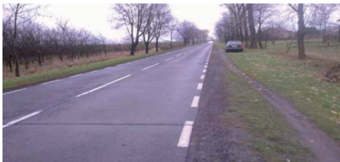
Fot. 2. Widok odcinka drogi Sobienie – Wilga w dniu 11.11.2015 r. Nawierzchnia betonowa wykonana w roku 1960. Jezdnia szerokości 6 m, szczeliny poprzeczne co 5 m. Szerokość szczelin rzędu 20 mm. Nawierzchnia użyteczna technicznie bez ograniczeń. Beton był wykonany bez domieszki napowietrzającej – źródło [1]
