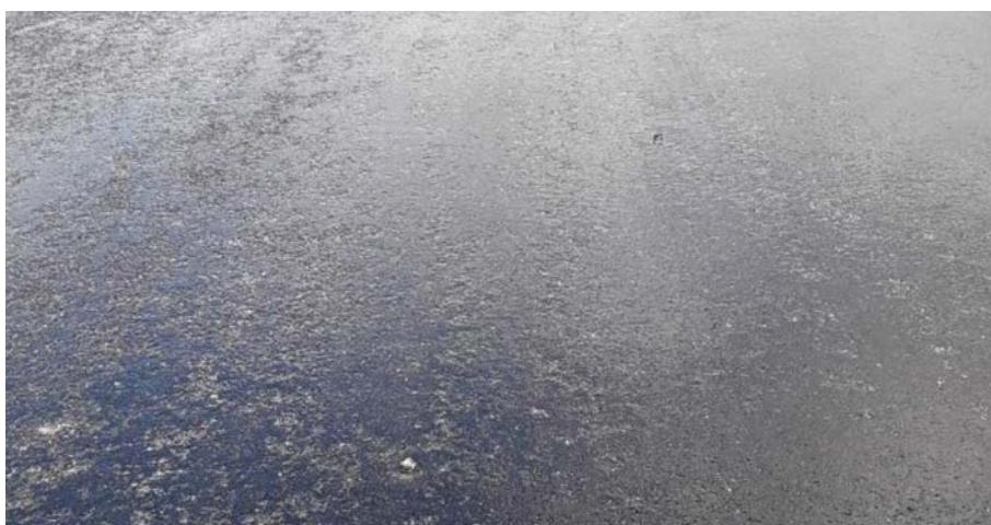
Fot. 3. Warstwa z mieszanki SMA-MA 8 PmB 65/105-60 po zagęszczeniu (widoczny wyciśnięty mastyks na powierzchni warstwy)
