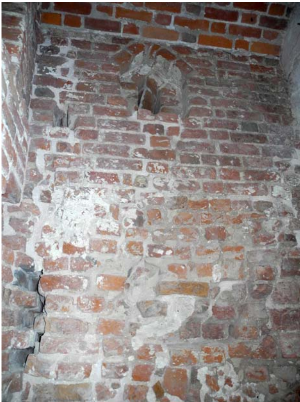
Ryc. 24. Wieża Klesza na Zamku Wysokim w Malborku. Piwnica, pomieszczenie nr 02. Narożnik południowo-wschodni. Widok na ścianę południową z oknem, zamurowanym od strony zewnętrznej. Partia środkowa muru nieregularna, wtórnie wypełniona, co mogło się łączyć z pęknięciem narożnika (fot. M. Prarat, 2015)
