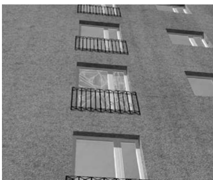
Rys. 10. Widok spalania płomieniowego z zewnątrz budynku po 2 min
