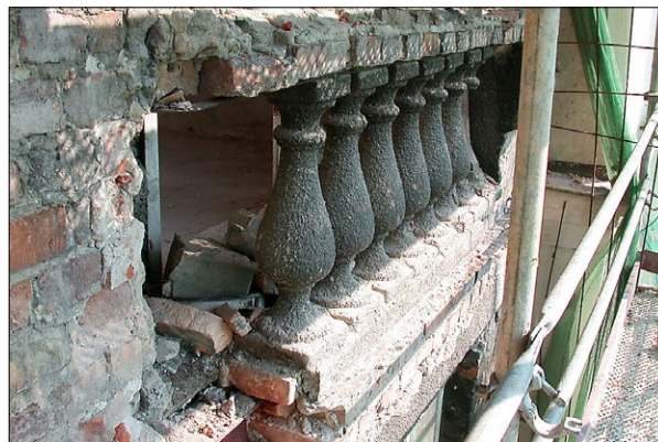
Ryc. 2. Detal architektoniczny w obrębie elewacji frontowej podlegający renowacji; fot. P. Przybysz. Fig. 2. Architectural detail within the front elevation subject to renovation; photo by P. Przybysz.
