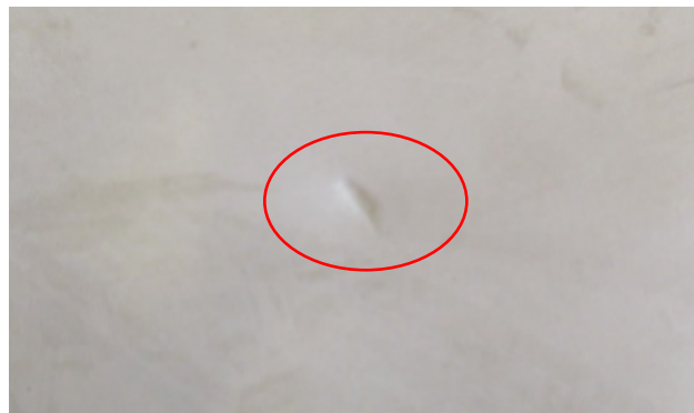
Rys. 7a. Uszkodzenie eksploatacyjne poszycia SP [8].
