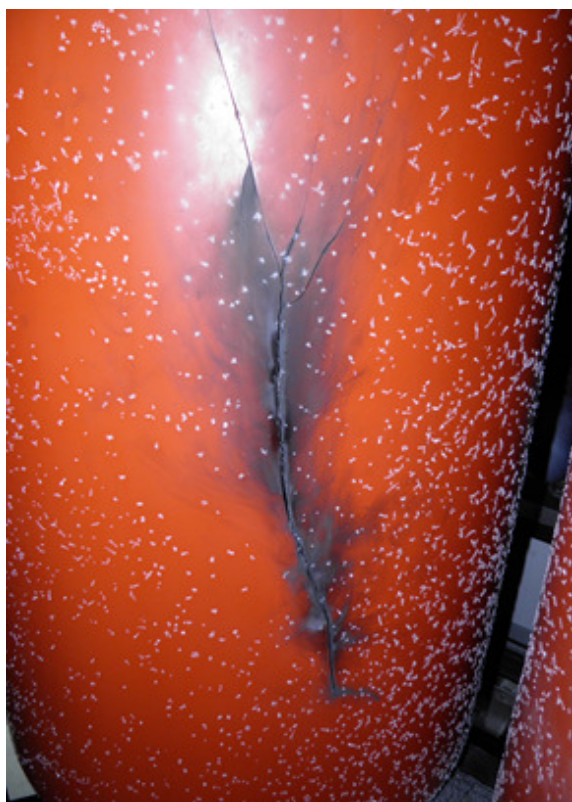
Rys. 2. Widok uszkodzonego uzwojenia fazy B uzwojenia 15 kV (fot. serwisu producenta)
