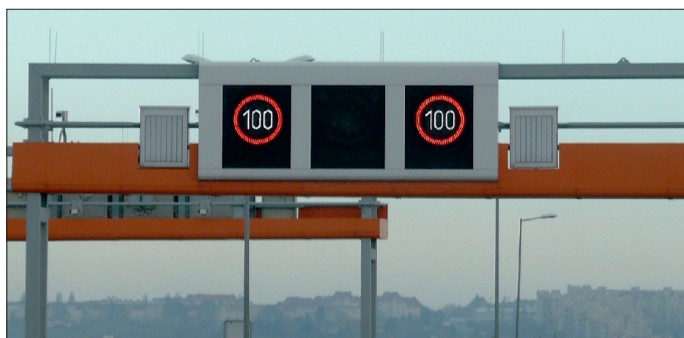
Fot. 1. Przykład piktogramowego ztt na drodze ekspresowej S-1 (Austria) (fot. Leszek Kornalewski)
