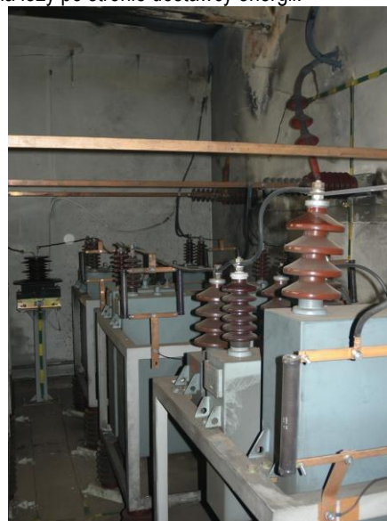
Rys. 6. Uszkodzona bateria kondensatorów wchodząca w skład instalacji zasilania stalowni
