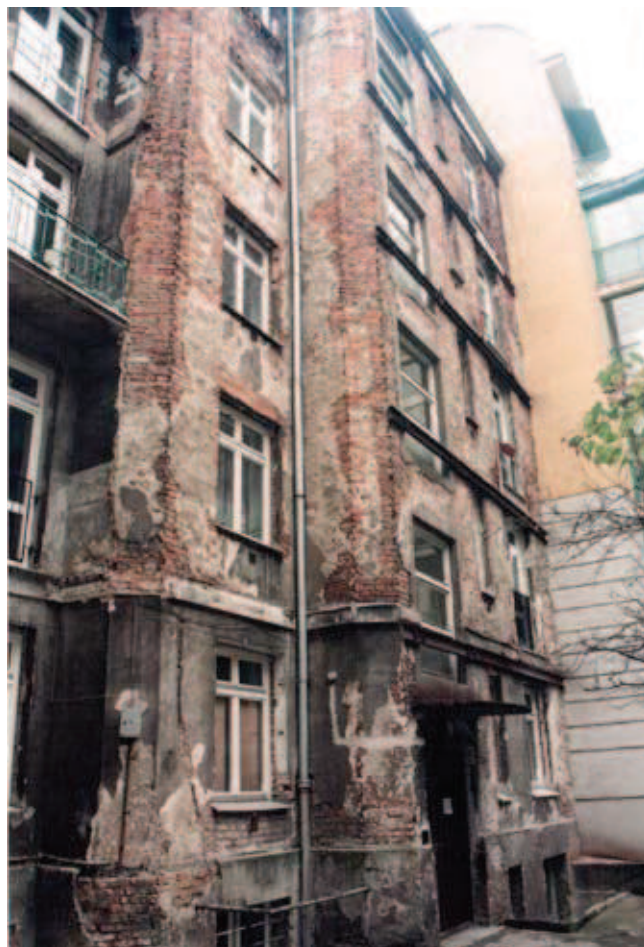
Rys. 2. Ocena i wzmocnienie budynku murowego
