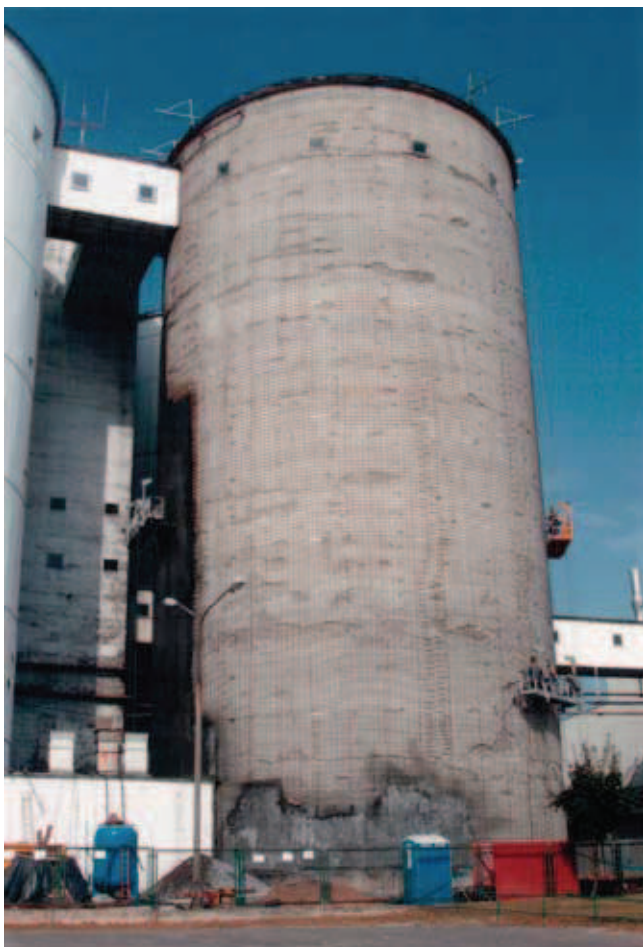
Rys. 1. Ocena wzmocnienia silosu żelbetowego na cement
