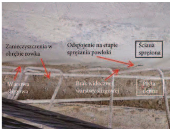
Rys. 5. Zanieczyszczenia w obrębie rowka uniemożliwiający weryfikację właściwego położenia warstwy poślizgowej
