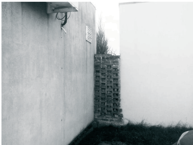
Rys. 1. Negatywny przykład plomby przedstawiający brak spójności zastosowanych materiałów. (fot. Autor)
