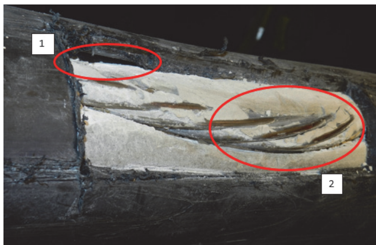
Rys. 11. Przykład nieprawidłowego wypełnienia kanału kablowego iniektem 1 – pustka w górnej części kanału kablowego (brak całkowitego wypełnienia iniektem) 2 – nalot korozyjny na splotach oraz lokalne ogniska korozji; zaczyn iniekcyjny o lekko żółtej barwie; niewielka pustka bezpośrednio pod splotem
