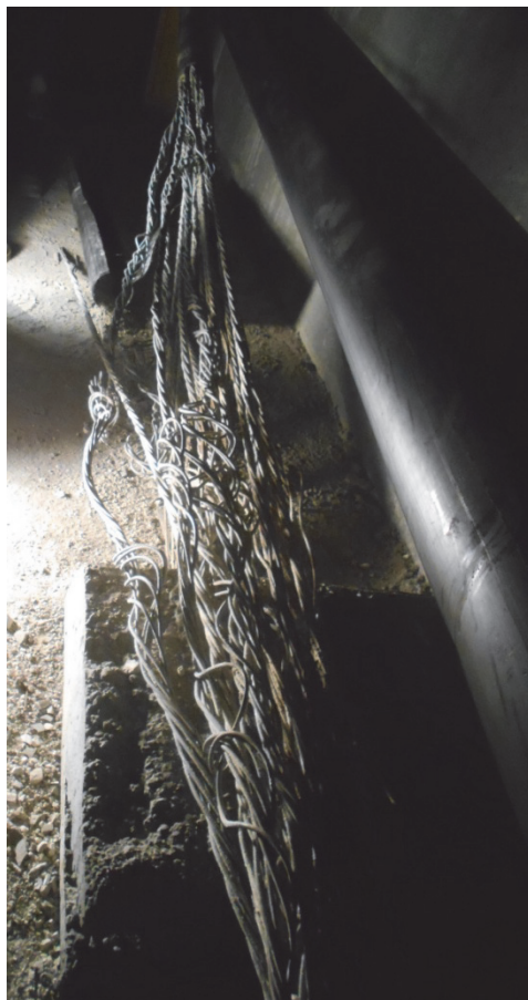
Rys. 1 Zerwany kabel sprężający zewnętrzny 31-splotowy po usunięciu osłony
