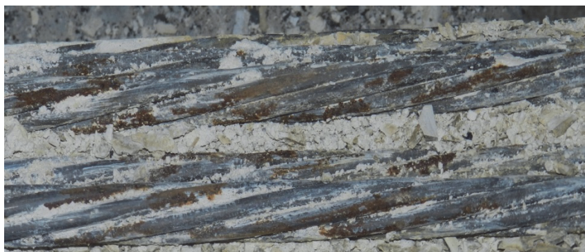
Rys. 5. Ogniska korozji na powierzchni kabla po usunięciu osłony i iniektu
