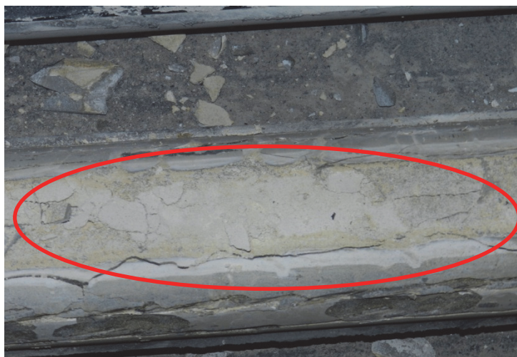
Rys. 12 Widok iniektu (w górnej, zaznaczonej części kanału kablowego) o nieprawidłowej strukturze i barwie, po usunięciu osłony kabla
