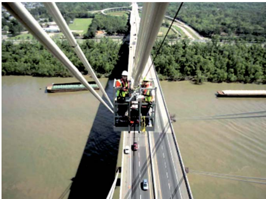
Rys. 12. Wózek zastosowany do kontroli stanu kabli podwieszających most Luling [Mehrab i in. 2010, Internet]
