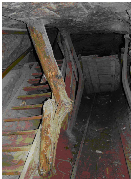
Rys. 1. Efekt zaciskania pionowego pochylni w rejonie wykonywania pomiarów
