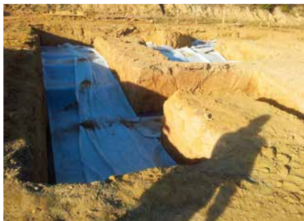
Fot. 4. Chudy beton to też beton, który wymaga ochrony
