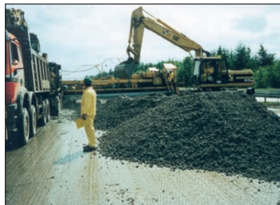
Fot. 2. Sposób organizacji pracy zespołu układającego podczas budowy drugiej warstwy nawierzchni betonowej systemem „mokre na mokre”
