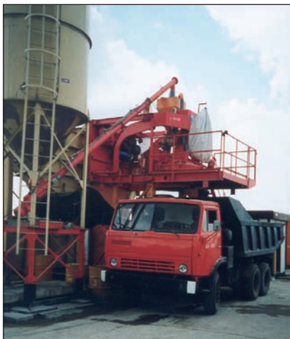
Fot. 1. Wytwórnia betonu o wydajności 50 m 3 /h, sterowana komputerowo i wyposażona w automatyczny system dozowania składników podczas pracy
