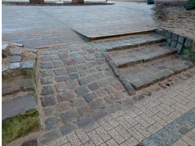
Fot. 7. Pochylnia stała w Parku Północnym niespełniająca potrzeb użytkowych, Sopot, fot. R. Stachańczyk 2022
