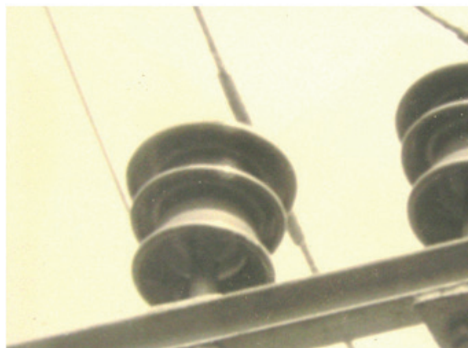
Rys. 1. Izolatory VHD20 na słupie linii 20 kV w Rejonie Kłodzka [6].
