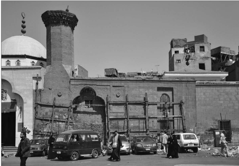
Ryc. 17. Prowizoryczne konstrukcje podpierające jedną z budowli w starej części Kairu (fot. Tomasz Kania, 2015)
