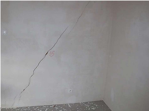
Rys. 11. Spękanie wewnętrznej podłużnej ściany działowej na I piętrze w segmencie 1 (mieszkanie 1) (Praca ... 2016)
