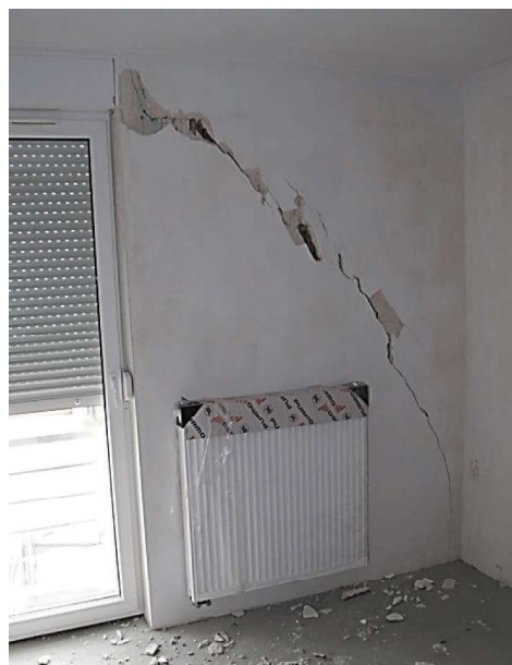
Rys. 9. Spękanie ściany zewnętrznej wschodniej osłonowej w poziomie I piętra w segmencie 1 (mieszkanie 1) (Praca ... 2016)
