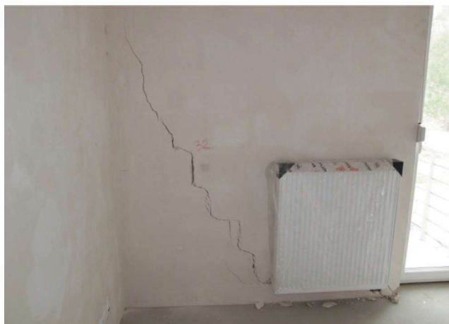
Rys. 8. Spękanie ściany zewnętrznej wschodniej osłonowej w poziomie I piętra w segmencie 1 (mieszkanie 1) (Praca ... 2016)
