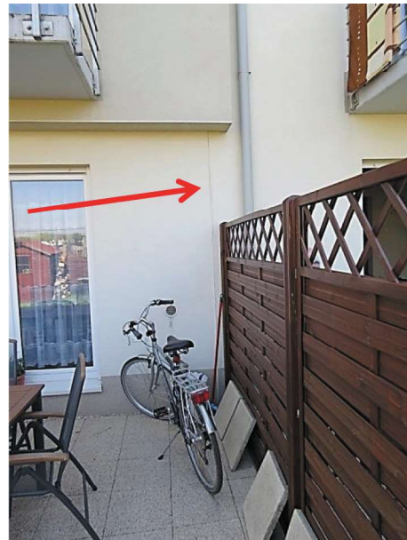
Rys. 12. Zaciśnięcie szczeliny dylatacyjnej pomiędzy segmentami 1 i 2 w warstwie termoizolacyjnej elewacji zachodniej (Praca ... 2016)
