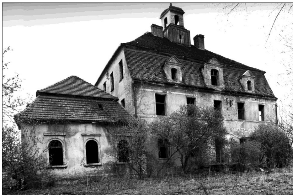
Fot. 4. Pałac – elewacja południowa, stan z 1978 r. [Kąsinowska 1978] Phot. 4. Palace – the southern elevation, state in 1978 [Kąsinowska 1978]
