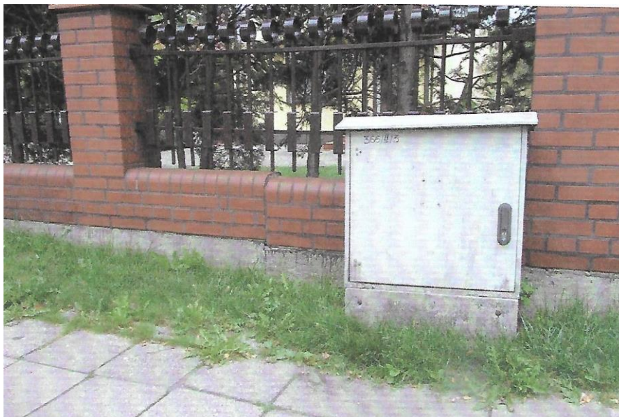
Fot. 2. Awaria ogrodzenia – Świebodzin, dz. nr 166/5 (2004 r.) Photo 2. Fencing failure – Świebodzin, land plot no. 166/5 (2004)
