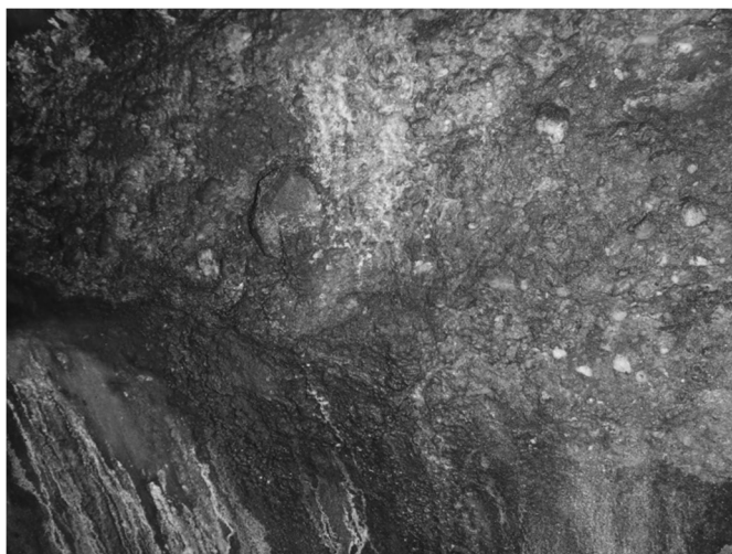
Rys. 8.7 Uszkodzenia betonu w rejonie złącza technologicznego
