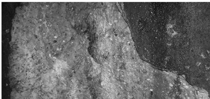
Rys. 8.6 Powierzchniowe odspojenie z obudowy betonowej szybu
