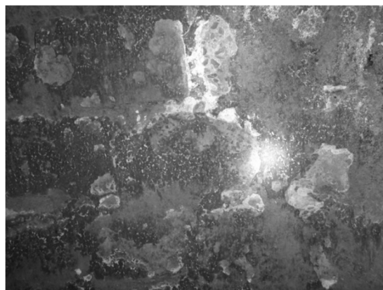
Rys. 8.3 Korozja obudowy betonowej szybu
