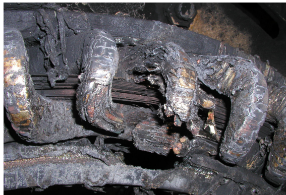
Rys. 16. Zniszczenia główek cewek
