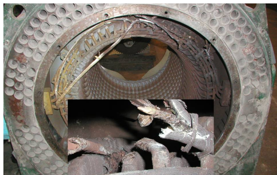
Rys. 17. Skutki zwarcia między połączeniami zasilającymi uzwojenie stojana
