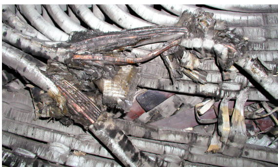
Rys. 14. Strefowe zniszczenie czoł cewek
