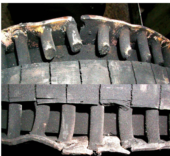
Rys. 19. Zerwane pręty i pęknięte pierścienie
