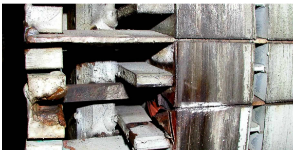
Rys. 20. Uszkodzenie wirnika jednoklatkowego
