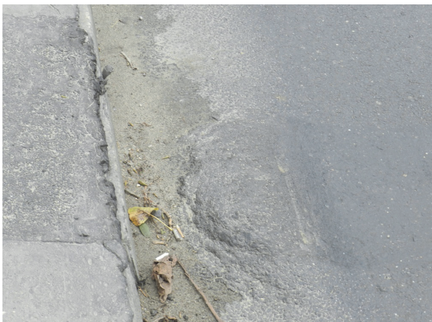
Fot. 17. Uszkodzenia nawierzchni, utrudniające odprowadzanie wody z pomostu
