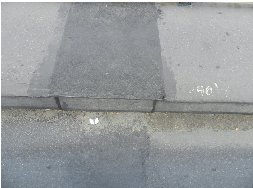
Rys. 16. Szczeliny w krawężniku sprzyjające przenikaniu wody do przegubu
