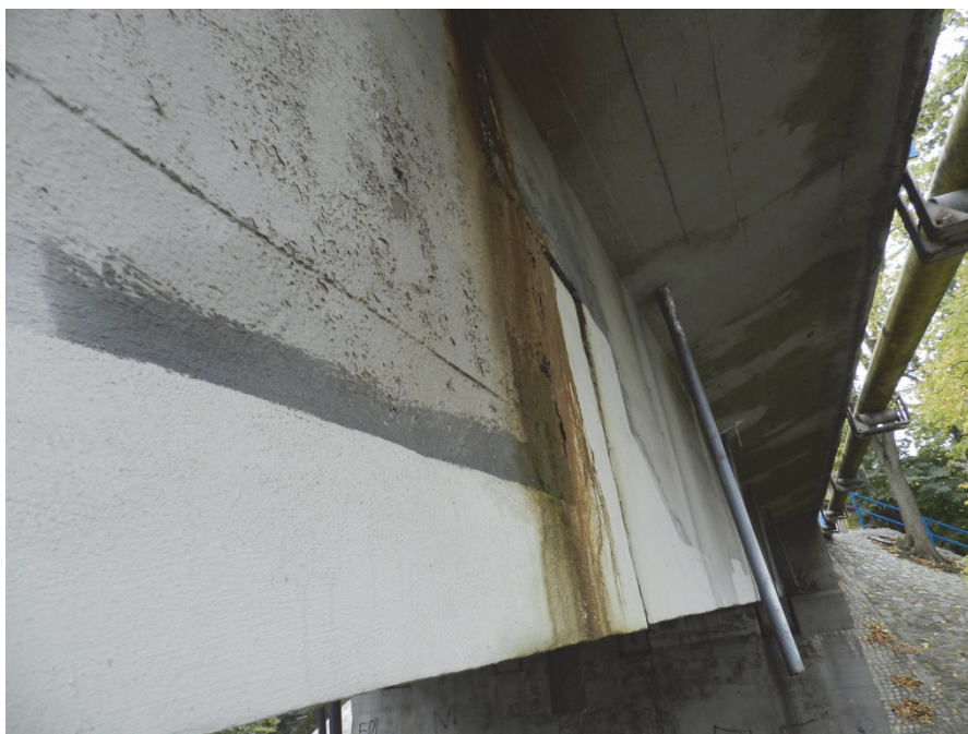
Rys. 20. Przecieki wody w miejscu przegubu
