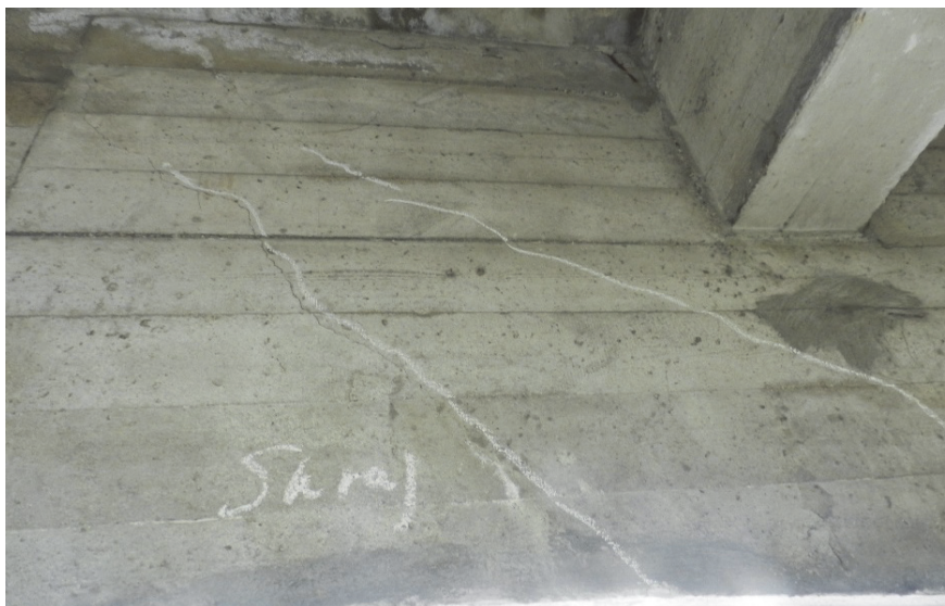
Rys. 12. Przykładowy układ rys jednego z dźwigarów głównych
