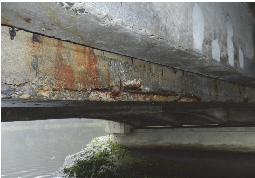
Rys. 18. Widok na przęsło od spodu – widoczna silna korozja zbrojenia i ubytki betonu (most przez Gwdę w Pile)
