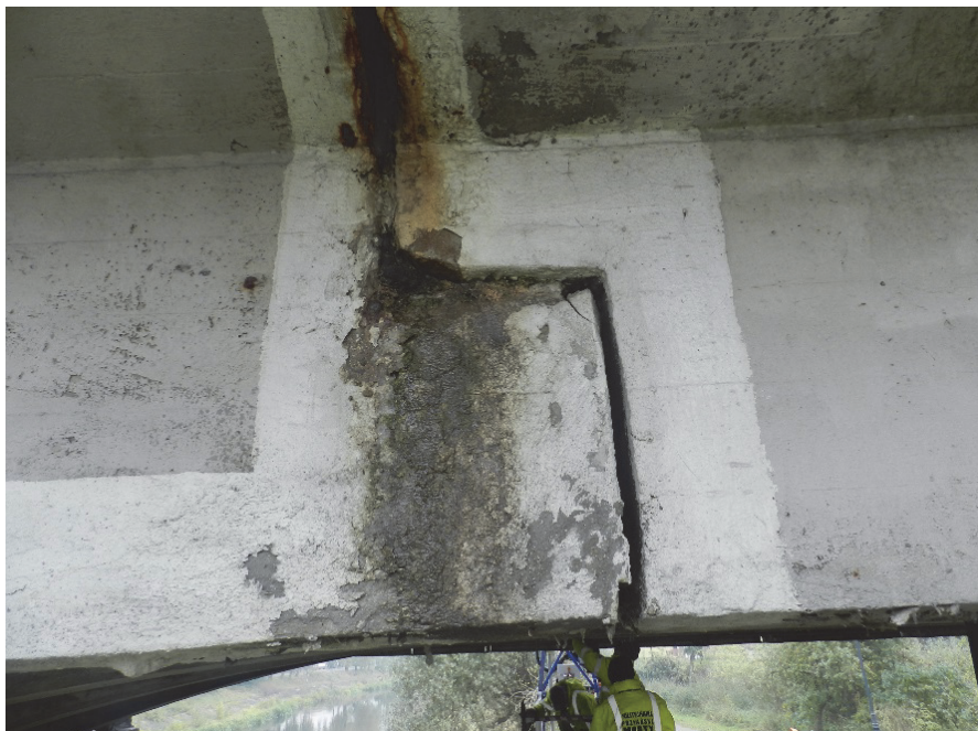
Rys. 14. Przepięki przez przegub – most przez Noteć w Ujściu
