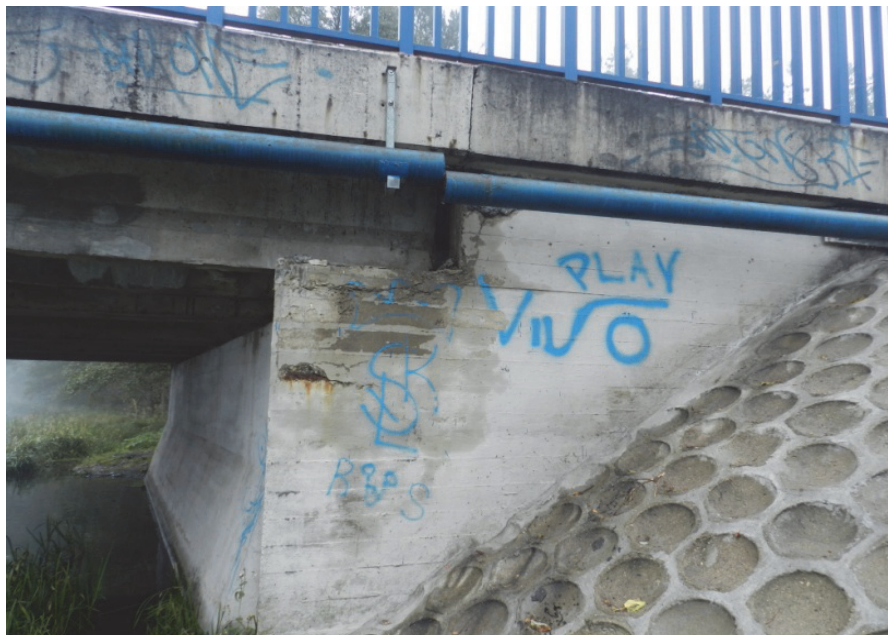
Rys. 22. Zacieki wody na belce gzymsowej i krawędzi przyczółka po rezygnacji z odwodnienia za pomocą wpustów i odprowadzenie wody przez krawędź przęsła
