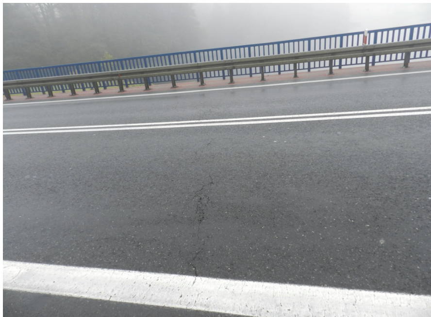
Rys. 19. Spękania nawierzchni nad przegubem
