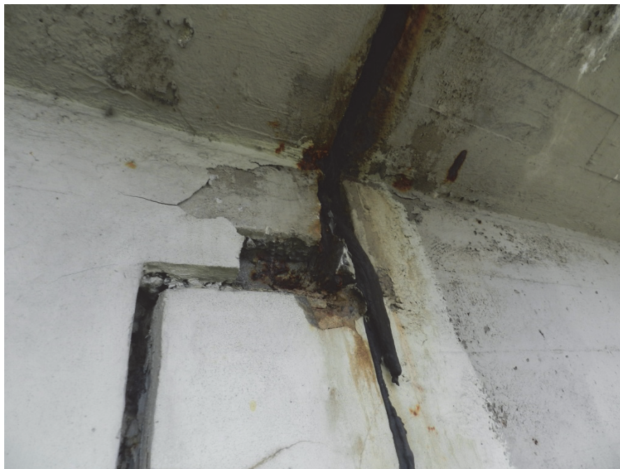
Rys. 13. Uszkodzenia korozyjne przegubu
