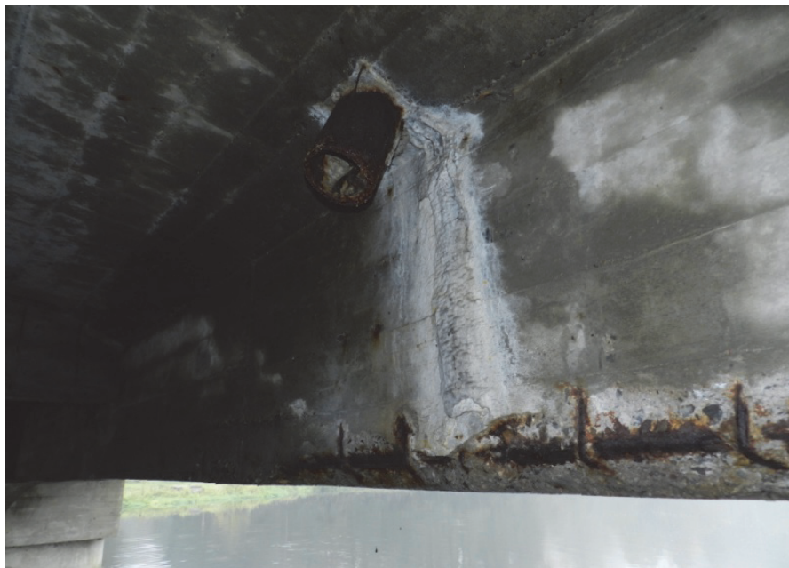
Fot. 21. Uszkodzenia przęseł w miejscu wadliwego osadzenia wpustu
