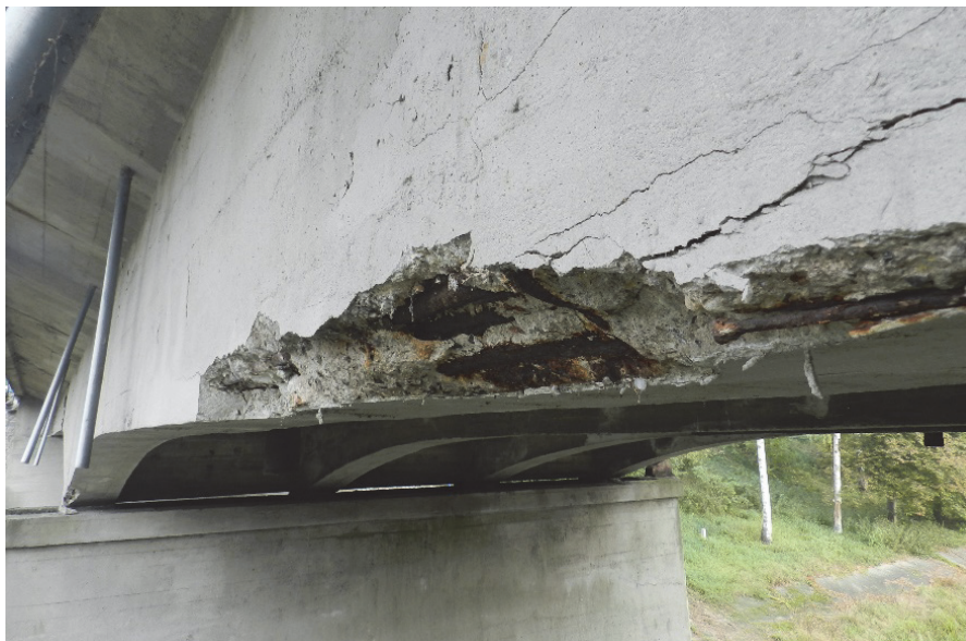
Rys. 10. Ubytki betonu i korozja zbrojenia
