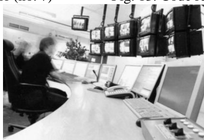
Rys. 14. Stanowisko kontroli systemu (nr 10) [7] Fig. 14. Control system (no. 10) [7]
