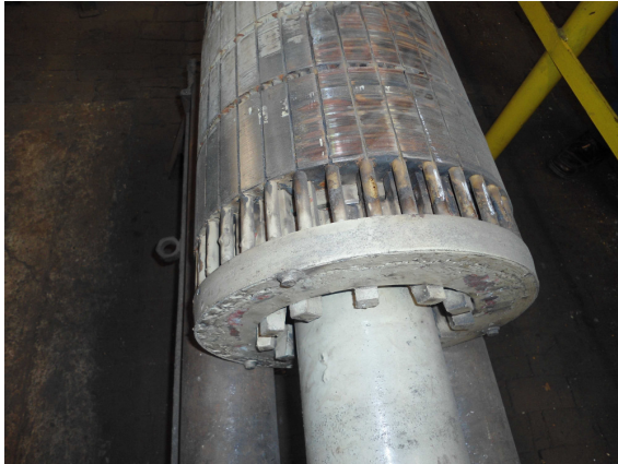
Rys. 4. Uszkodzony wirnik po wyjęciu z maszyny
