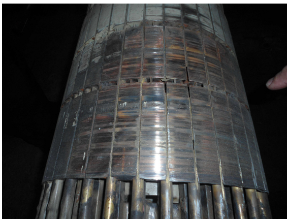
Rys. 5. Widok uszkodzonego wirnika, wskazanie miejsca uszkodzeń w klatce rozruchowej
